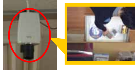
天井設置カメラ
